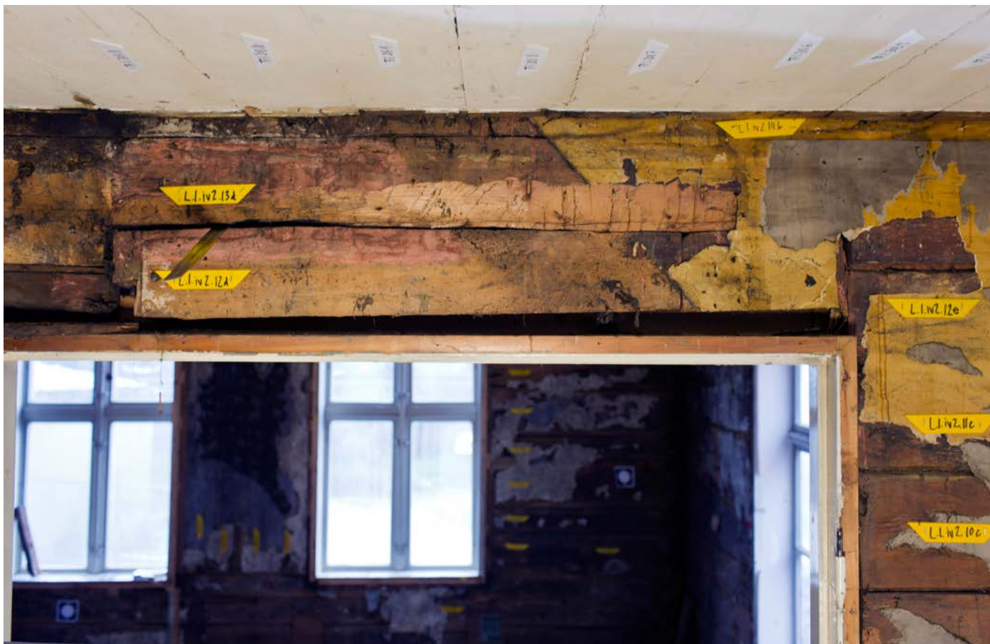
Over: Spor etter opprinnelig døråpning med rester av beitskier samt negativspor etter trappevangen. Vestvegg.
