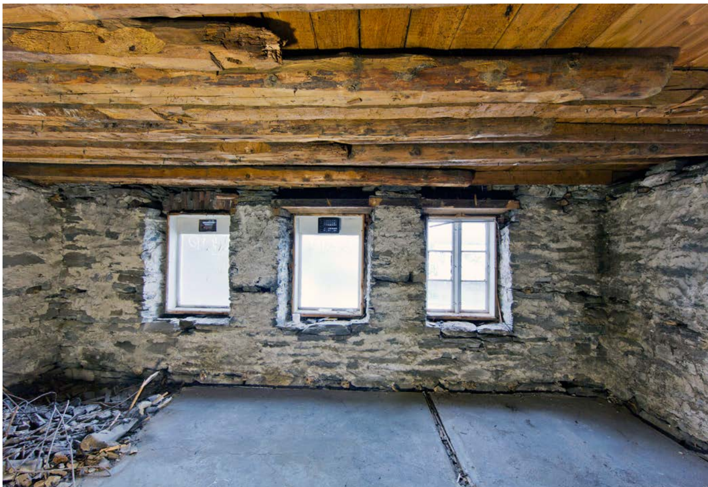
Over: Vegg mot vest. på bakgrunn av litografi 1848 antas at utgangsdør var ved søndre (til venstre) vindu.
