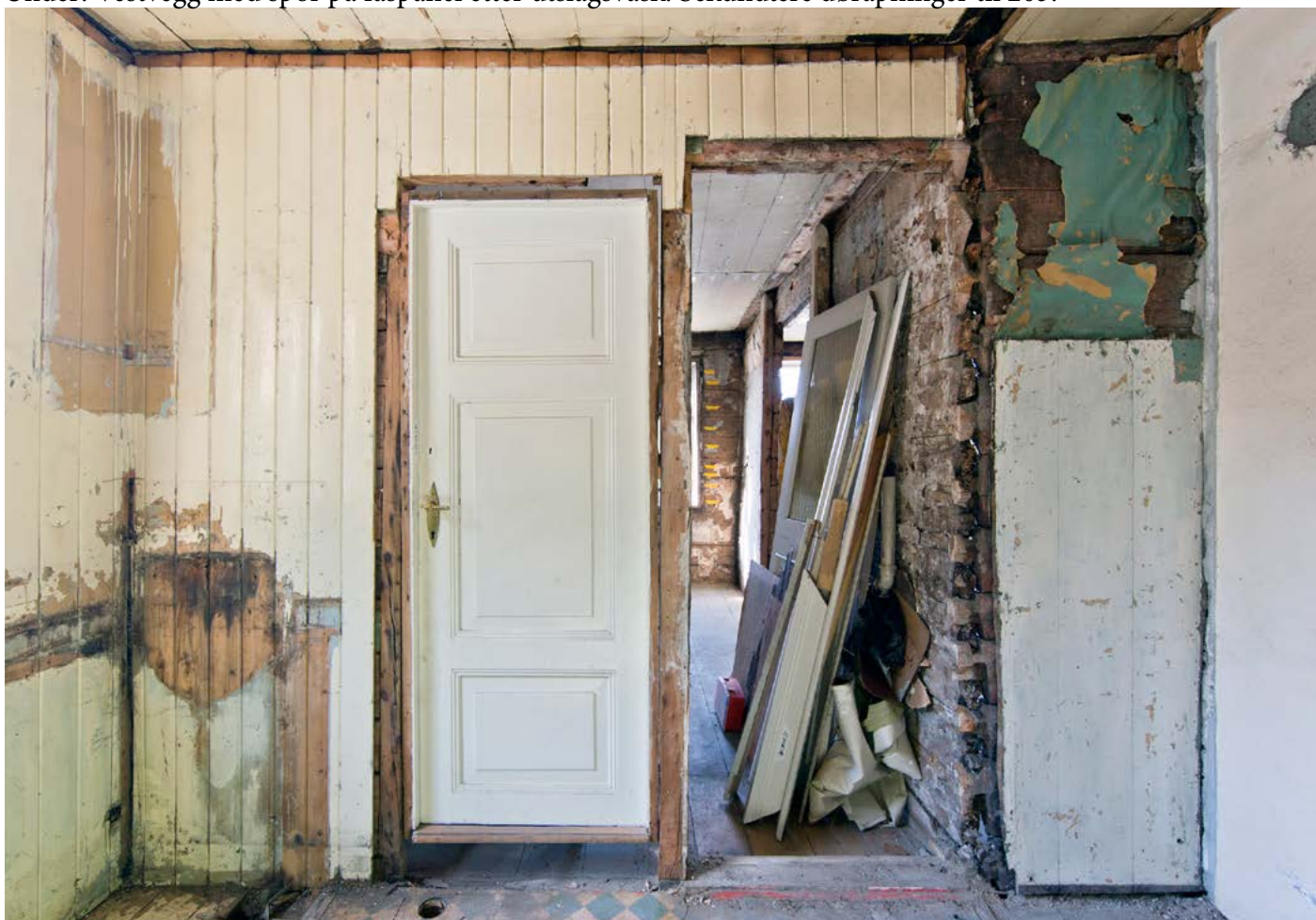
Under: Vestvegg med spor på faspanel etter utslagsvask. Sekundære døråpninger til 205.
