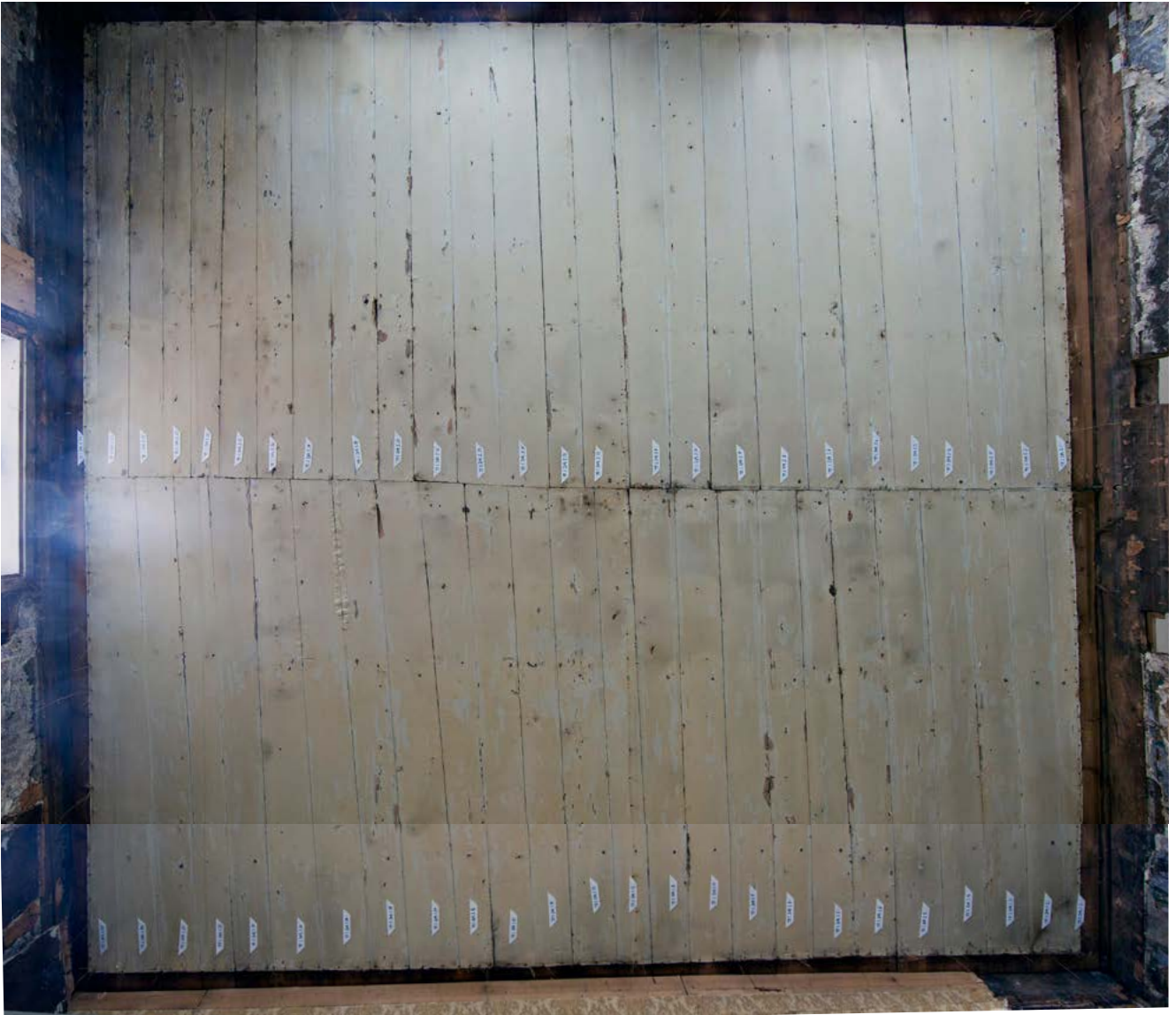
Himling av pløyde malte bord, antagelig 1830-årene. Ned er øst. Høyre side er syd.
