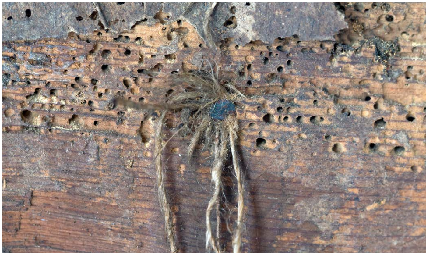
Over og under: Rester av lerret/strie funnet til høyre for brannmur. Ingen tilsvarende spor ellers i rommet.
