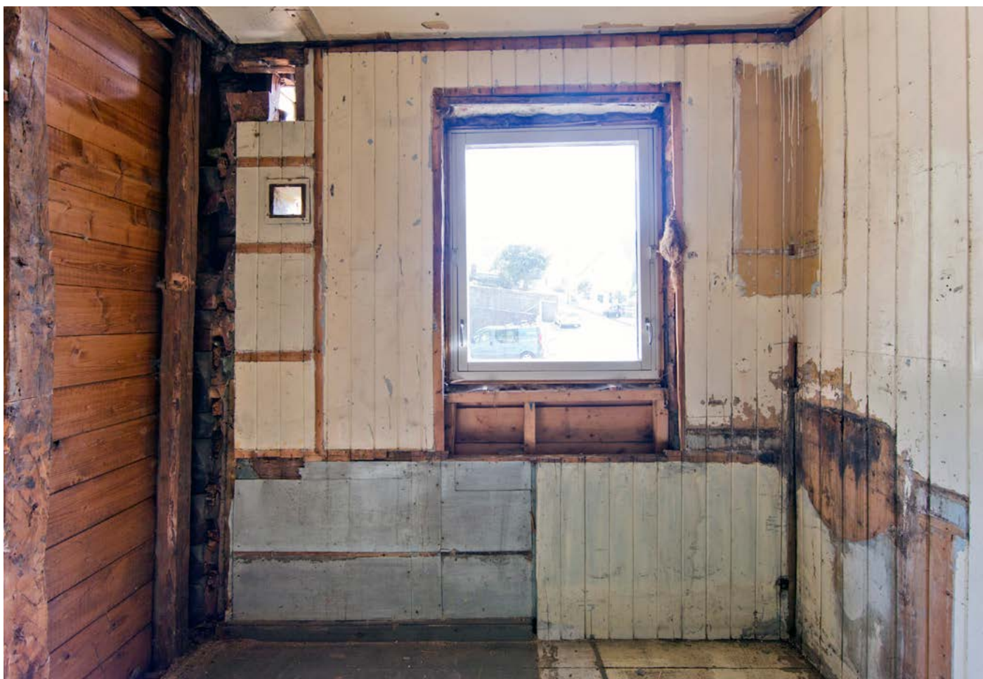
Over: Sydvegg med spor på faspanel etter kjøkkeninnredning.
